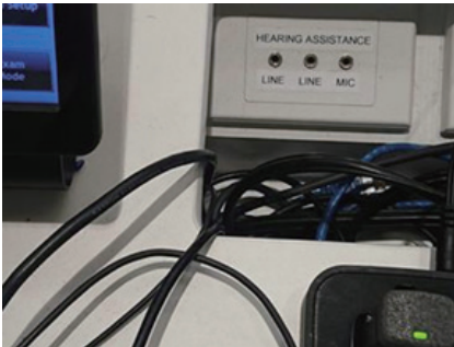
뉴질랜드 오클랜드대학 강의실에 설치된 히어링 루프 관련 기기 12
