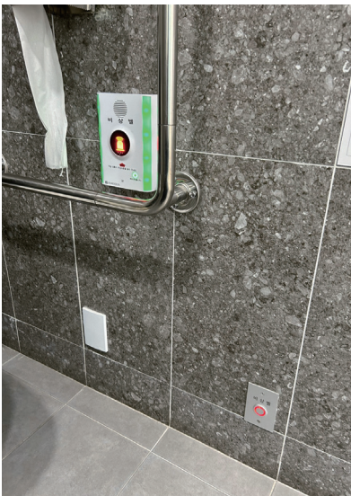
대변기 상부와 하부에 설치된 비상호출벨 @배용호
