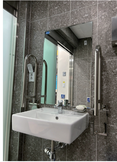
세면대 양측에 상하회전 손잡이(핸드레일)와 전면 거울을 설치한 사례 @배용호
