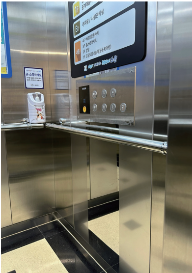
엘리베이터 내부 벽 중앙에 설치되고 내부 수평손잡이와 겹치지 않도록 설치된 가로조작반 @배용호
